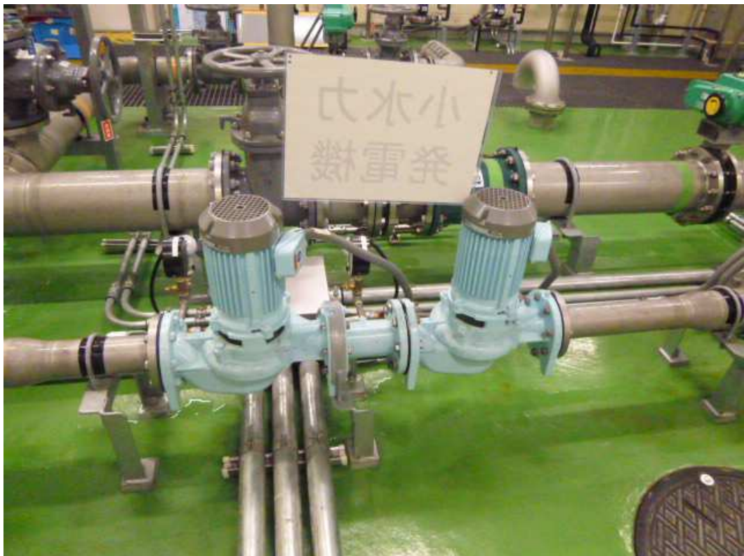
小水力発電設備
